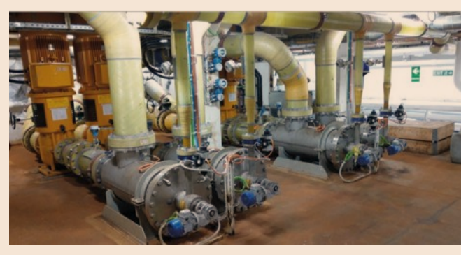
Filtrazione acqua mare impianto EGCS
